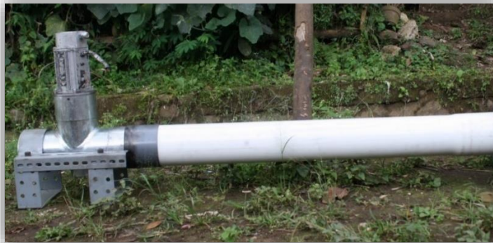
Gambar 3.19. Sistem Pembangkit Listrik Skala Piko hidro dengan menggunakan Turbin Bulb .
