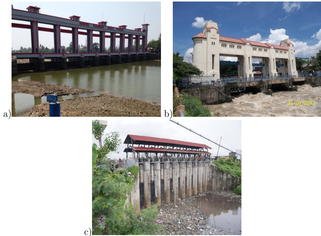
Figure 1.1: Beberapa contoh pintu air di Indonesia: a) pintu air Bendung Pasar Baru [1], b) pintu air Jagir [11], c) pintu air Demangan [5].
