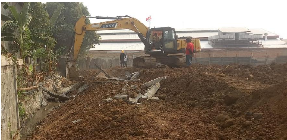
Gambar I. 4 Tenaga Harian Kontraktor Tidak Menerapkan Keselamatan dan Kesehatan Kerja (K3)
